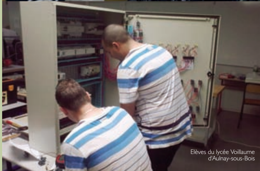
Système de gestion du chauffage
